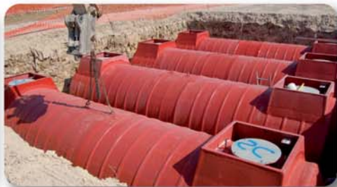
Installazione di batteria di serbatoi PetrolTank presso PV Conad Installation of a series of Petroltanks, at Conad service station
