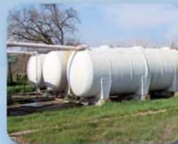
Impianto fuori terra per reflui caseari Aboveground Depuration Plant for Dairy Wastewater
