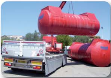
Carico dei serbatoi da 50mc PetrolTank 50m3 PetrolTank loading operation
